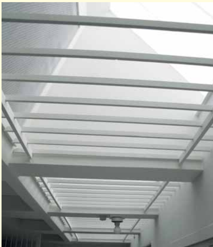
Nye ventilationsriste i loftet
